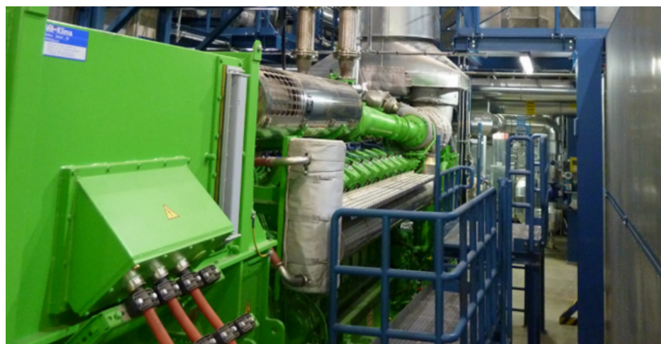
BHKW Ulm/Senden – Anlageobjekt ZUKUNFTSENERGIE DEUTSCHLAND 4
