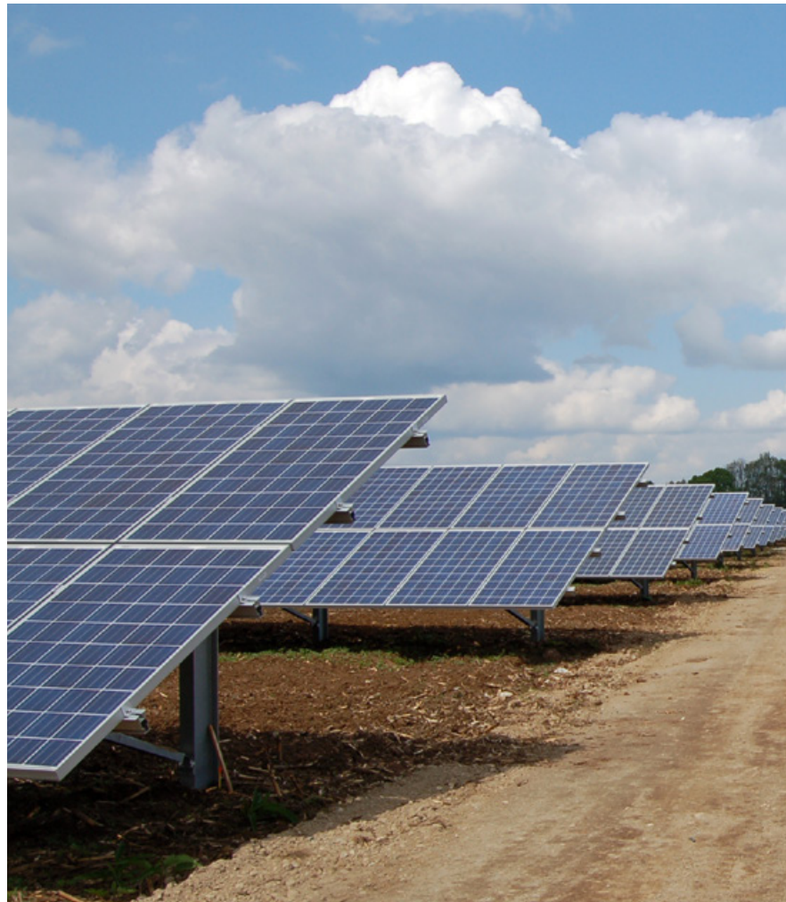
Frankenförde – Anlageobjekt SOLARENERGIE 2 DEUTSCHLAND
