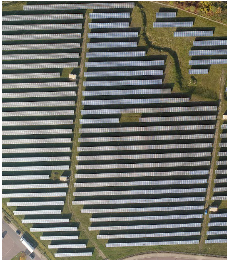
Halle – Anlageobjekt SOLARENERGIE 3 DEUTSCHLAND
