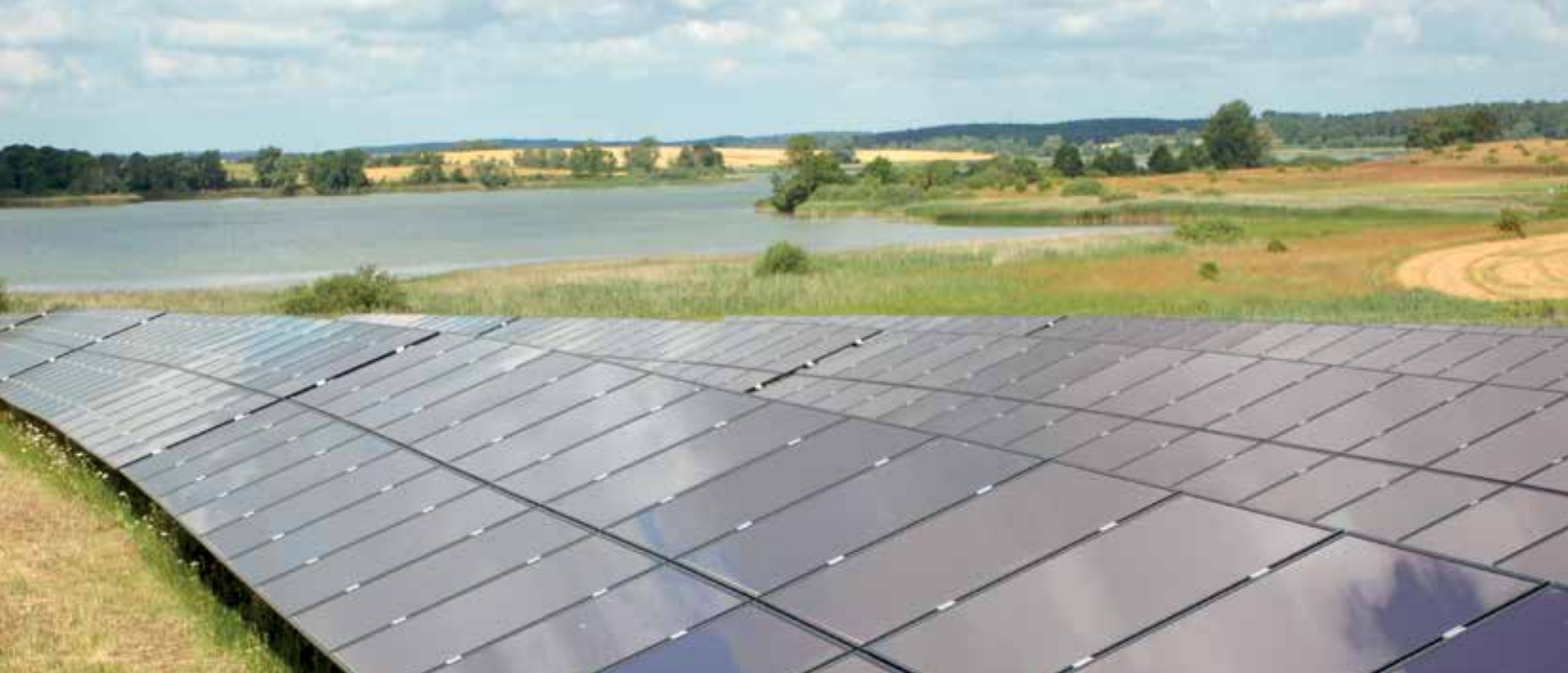
Solarpark Blankenberg – Anlageobjekt Solarenergie Nord
