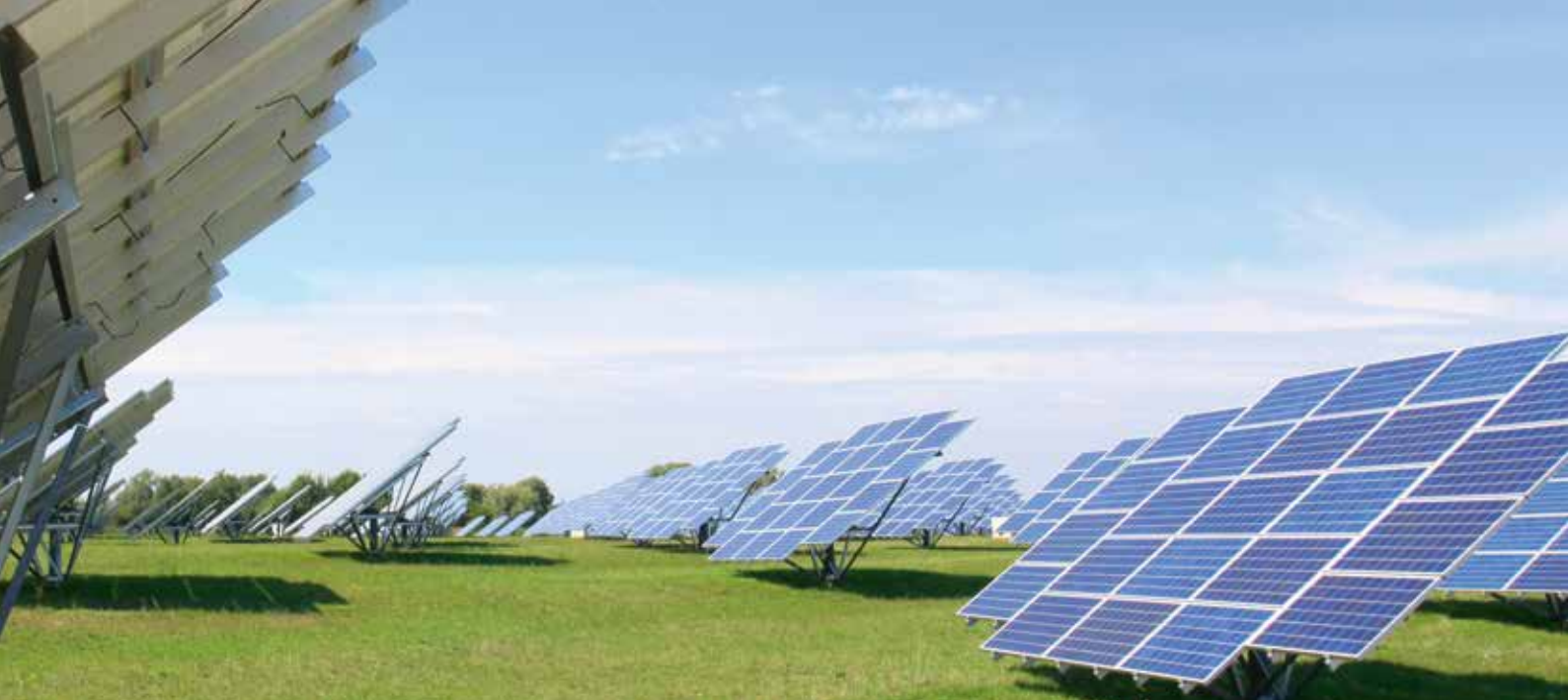
Solarpark Herzfelde – Anlageobjekt Solarenergie 2 Deutschland
