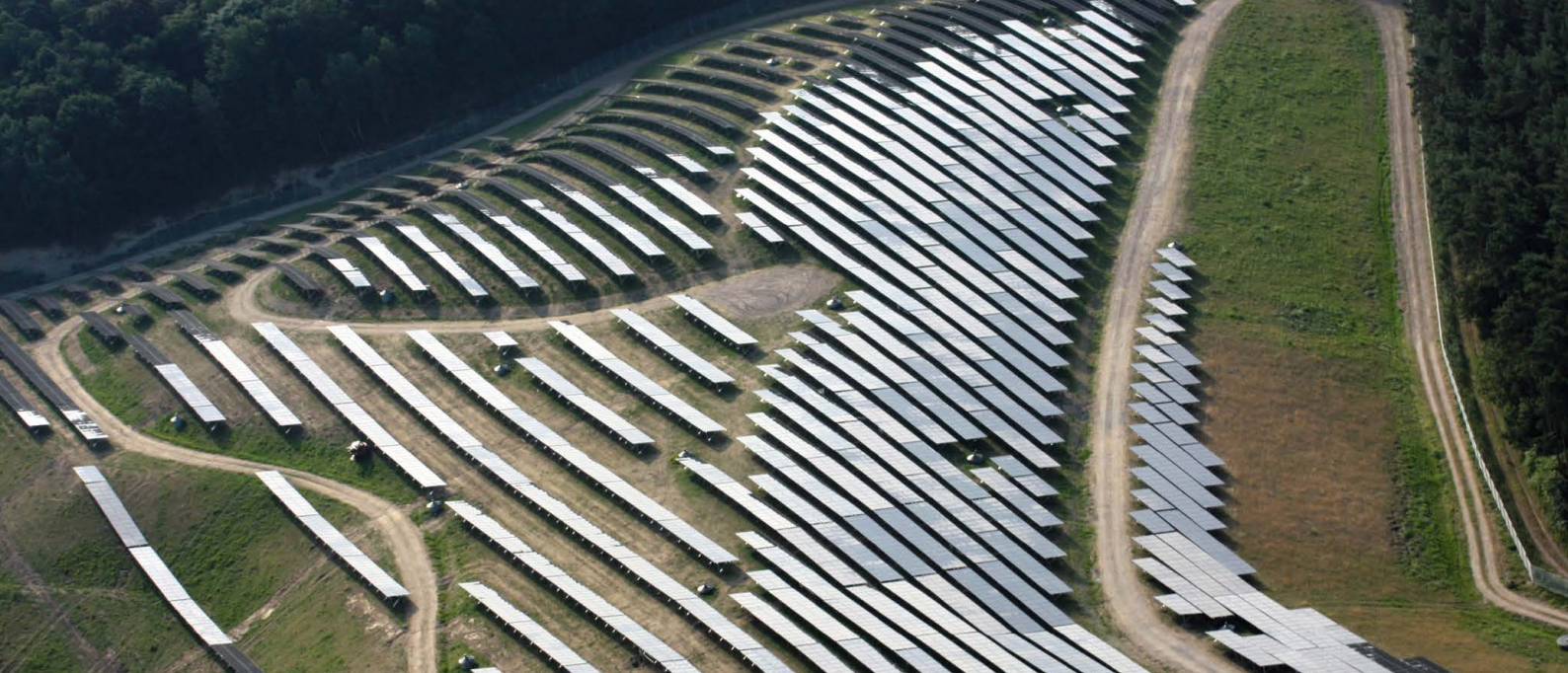
Solarpark Glasewitz – Anlageobjekt Solarenergie Nord
