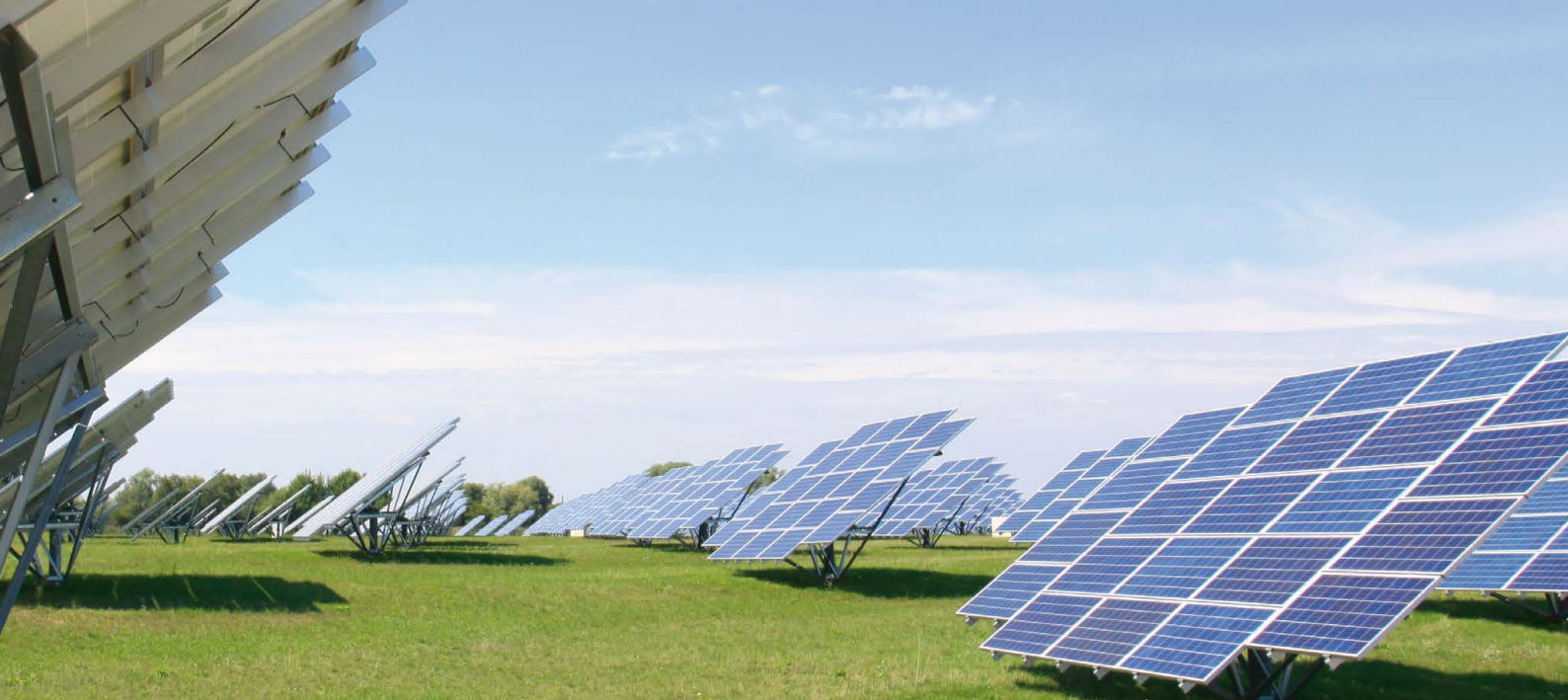
Solarpark Herzfelde – Anlageobjekt Solarenergie 2 Deutschland
