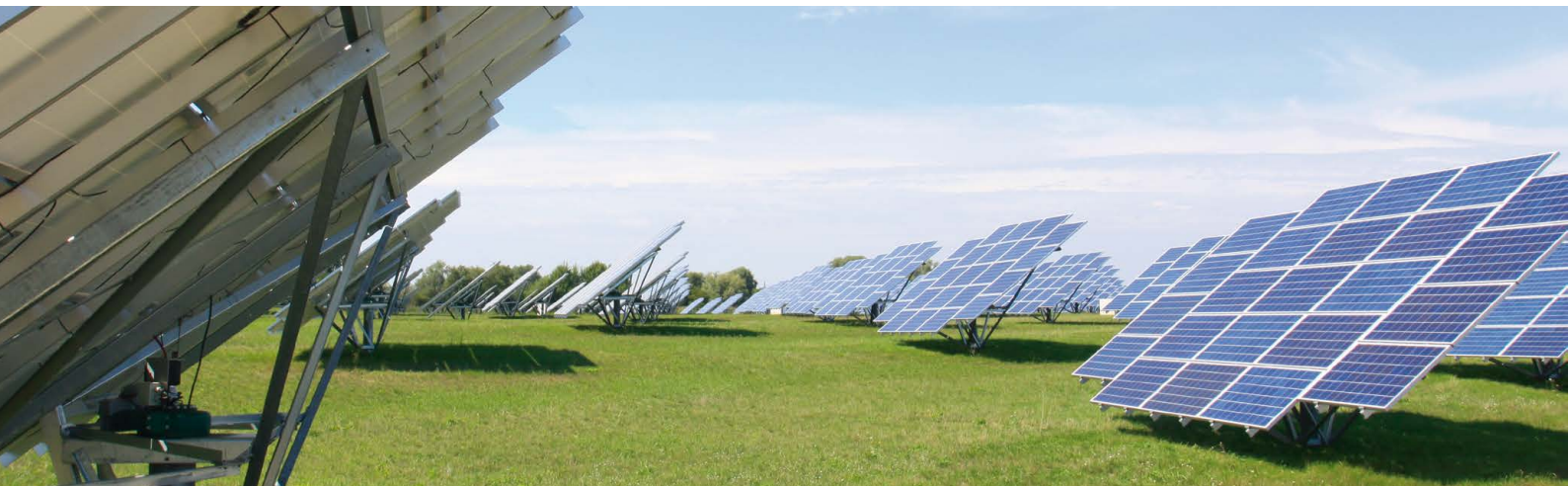
Herzfelde – Anlageobjekt SOLARENERGIE 2 DEUTSCHLAND
