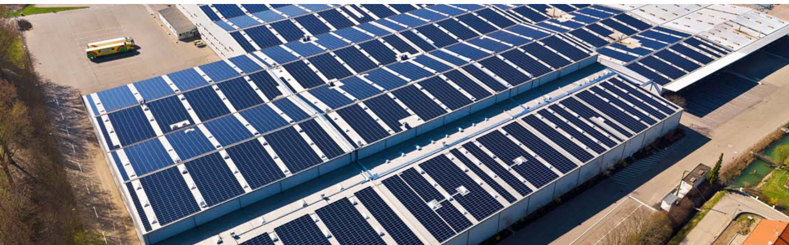
Solarpark Rain – Anlageobjekt SOLARENERGIE 3 DEUTSCHLAND
