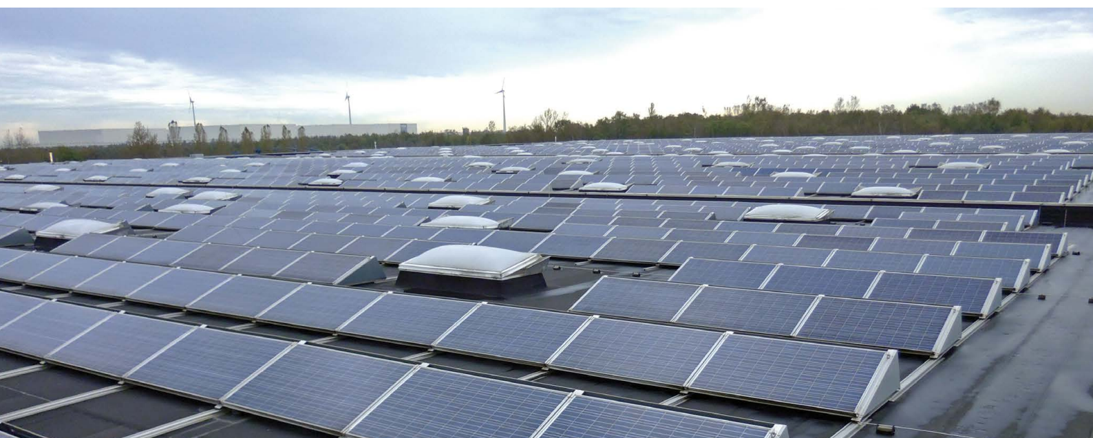
Beispiel einer Photovoltaik-Dachanlage
